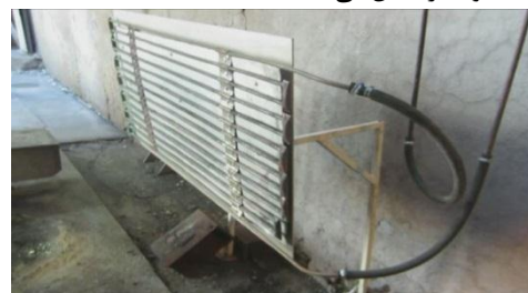
شکل (۴): تصویری از کلکتور ساخته شده در محل نصب
